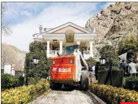
عاقبت بی‌قانونی! اقدامات عملی قوه قضاییه در حفظ حقوق و مینت از بیت‌المال مبنی بر رفع تصرف و آزادسازی اراضی رودخانه کرچ به نفع عامه، با تخریب ابر ویلای حاشیه رودخانه کرچ ادامه پیدا کرد. آزادسازی منابع طبیعی، درخواست همه مردم ایران است.
