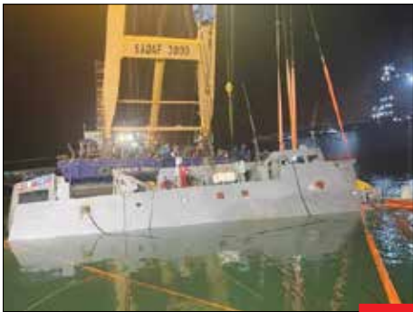
نجات سپند ، ناوچه سپند که ۱۷ تیرماه و در جریان تعمیرات در یک اسکله در نزدیکی بندرعباس دچار حادثه شده بود، شب ۲۹ تیرماه با تلاش واحدهای مختلف فنی و مهندسی نیروی دریایی و نیز همکاری تجهیزات جمع‌گشتی‌سازی و صنایع فراساحل ایران از آب بیرون کشیده شد. سپند بیش از ۱۳۰۰ تن وزن دارد که با توجه به وضعیت فرورفتگی در آب، این وزن تا چند برابر افزایش یافته بود.
